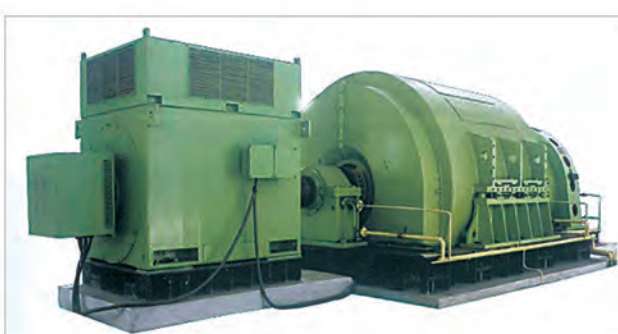
15000kVA/6.3kV工频机组 15000kVA/6.3kV power frequency unit
