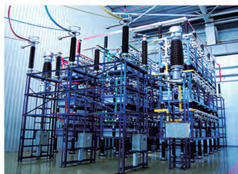
过负荷能力试验用大功率补偿装置 High power compensation device for overload capacity test
